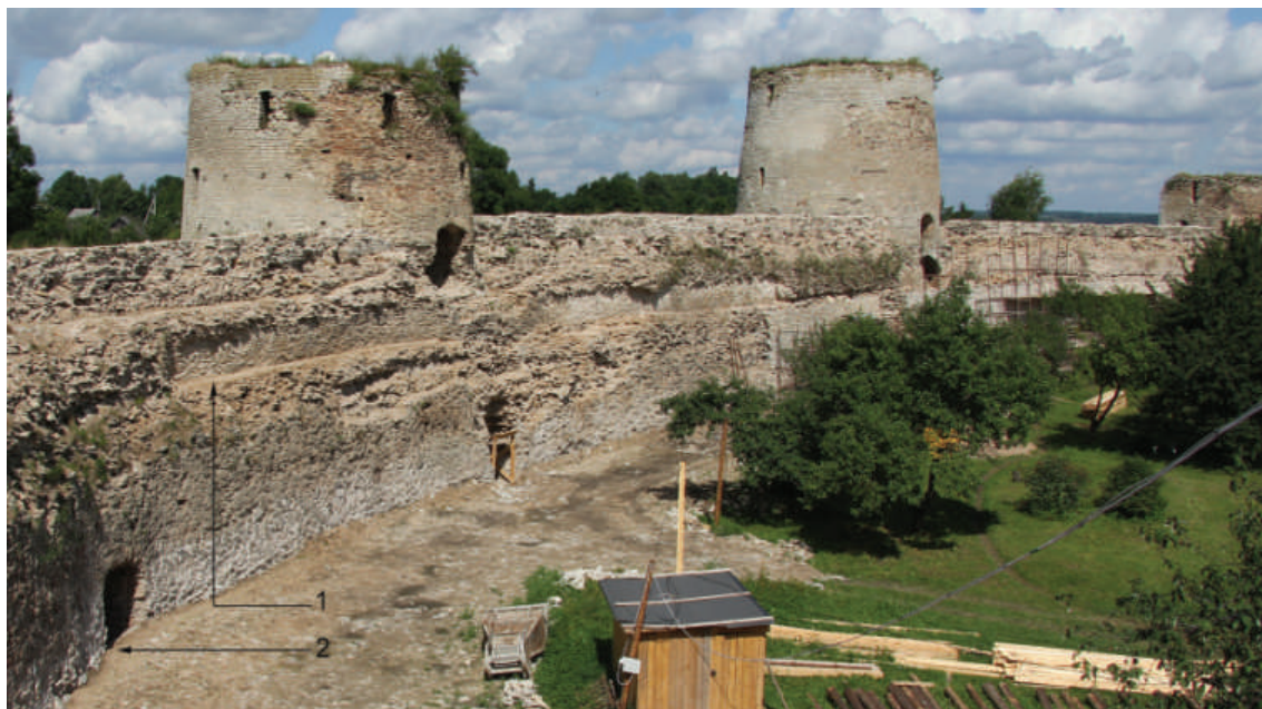
Рис. 5. Западная стена, общий вид с юго-востока. 1 — уровень ходовой площадки стены 1-го строительного этапа; 2 — ворота в западной стене 1-го строительного этапа
